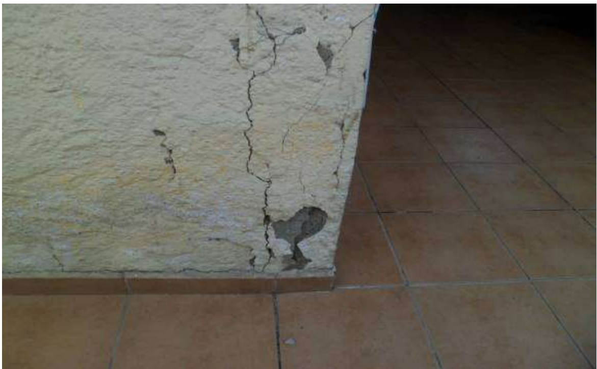
FOTO nº 10 Vista da parede, com detalhe para as trincas.
