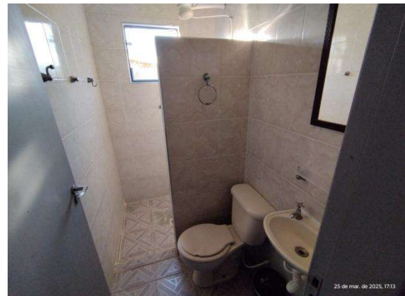
Foto 11 – Banheiro da suíte 1, todos os demais são com o mesmo acabamento, alterando somente a disposição
