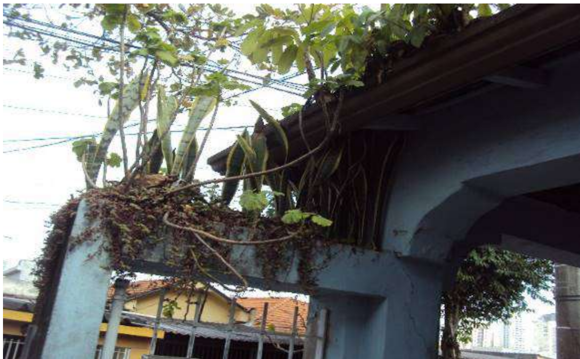
FOTO nº 23 – Outra vista do telhado, com detalhe para a vegetação presente no muro.
